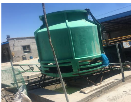
生产废水循环装置
