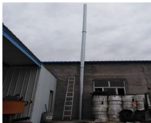
有机废气排气筒
