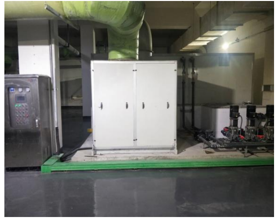
二期扩建生物除臭设备
