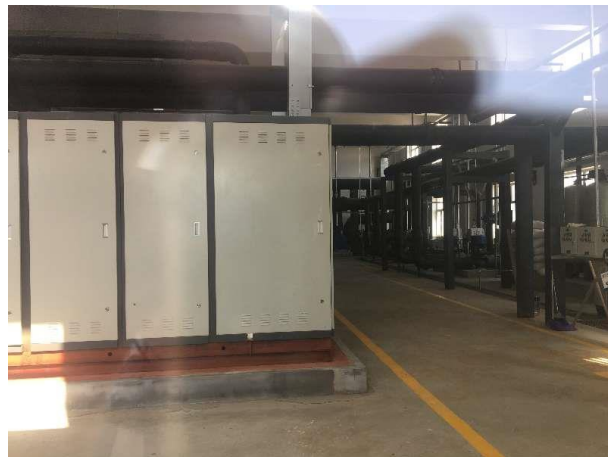
水源热泵设备
