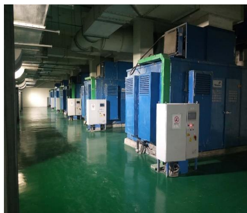
二期扩建鼓风机房
