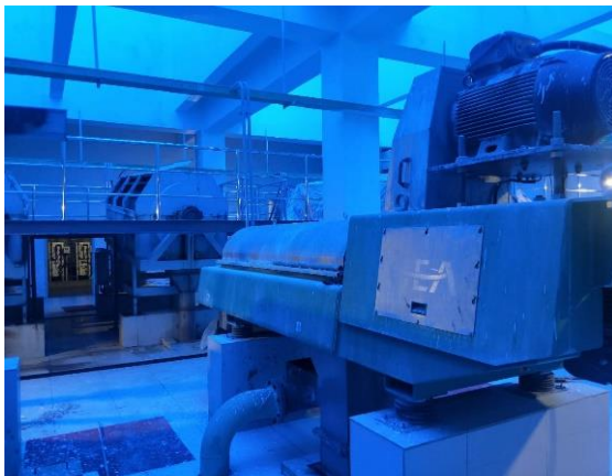
二期扩建污泥脱水机房
