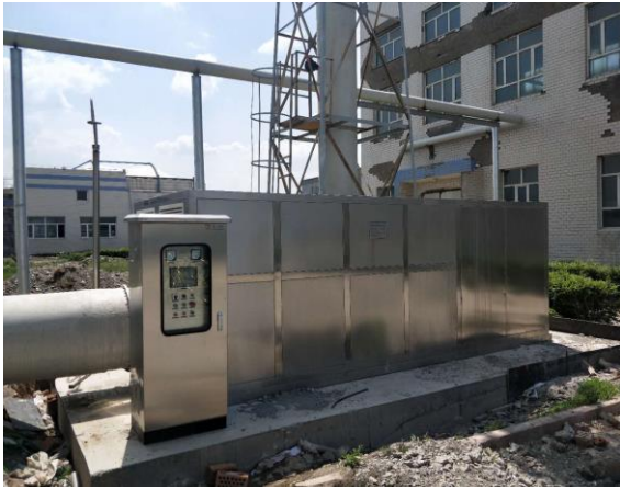
一期提标改建离子除臭设备
