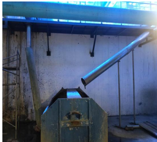
二期扩建栅渣处理
