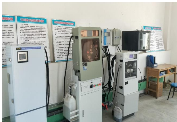
出水在线监测设备间
