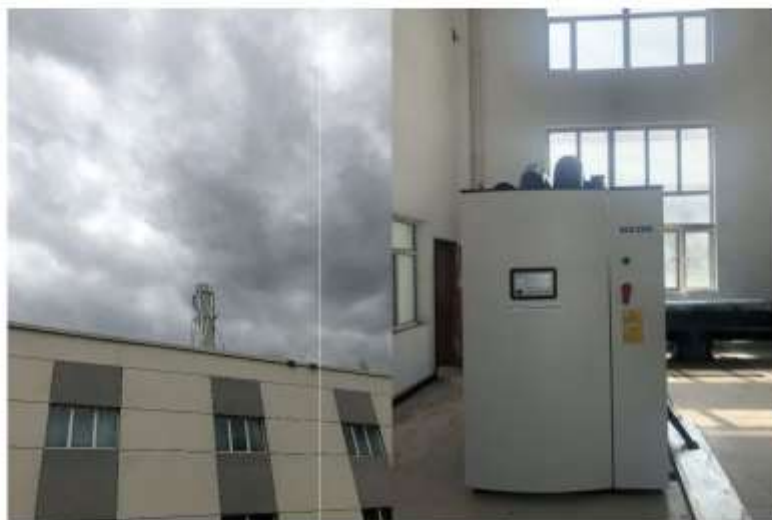
生物除臭车间
