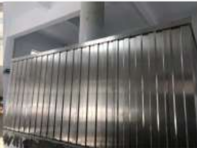
生物除臭设备
