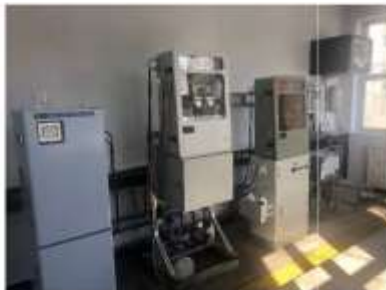
出水在线监测设备间
