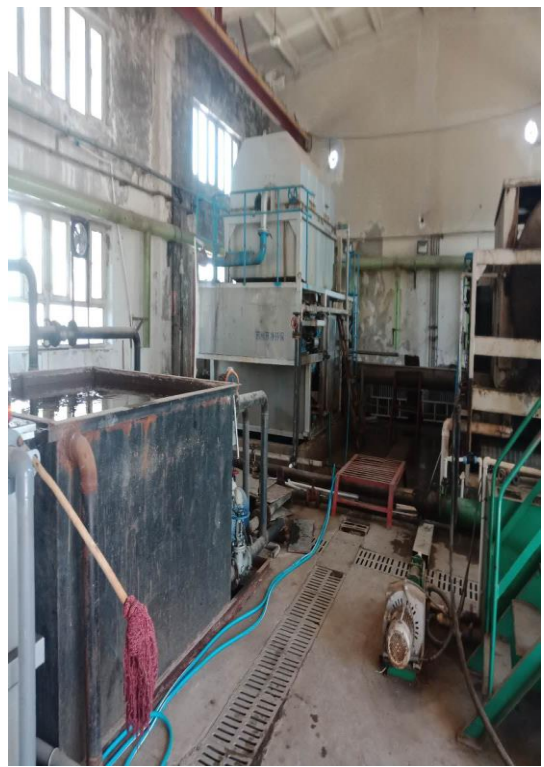
污泥脱水车间
