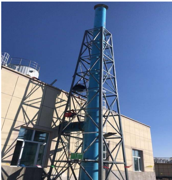
污泥脱水车间离子除臭排气筒
