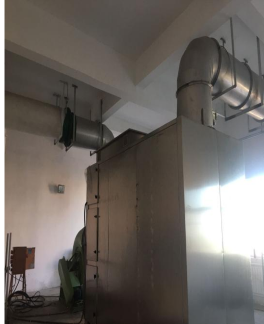
污泥脱水车间离子除臭设备
