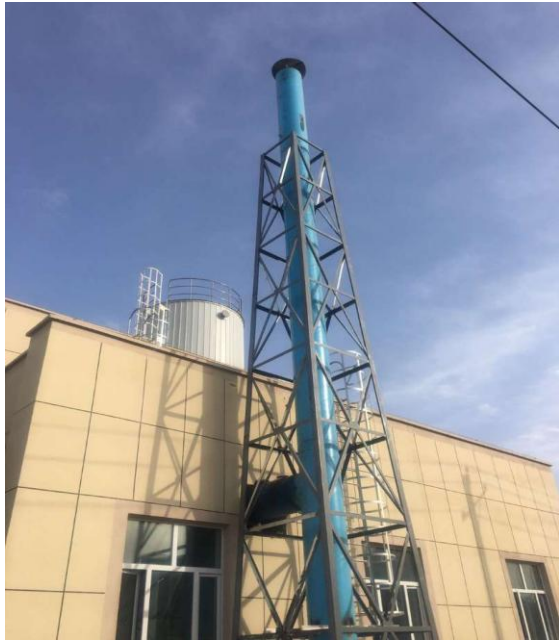
污水提升泵房及精细格栅间离子除臭排气筒
