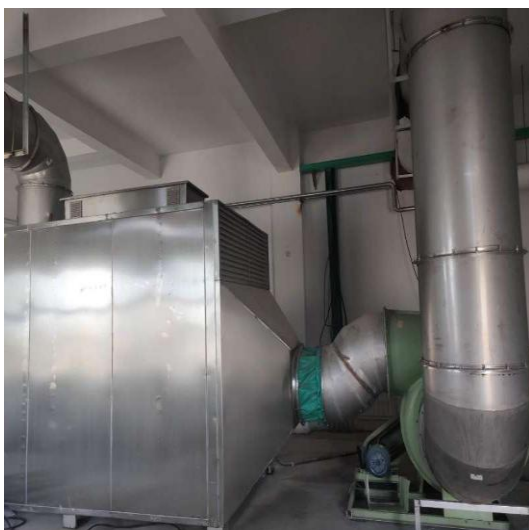
提升泵房及精细格栅间离子除臭设备
