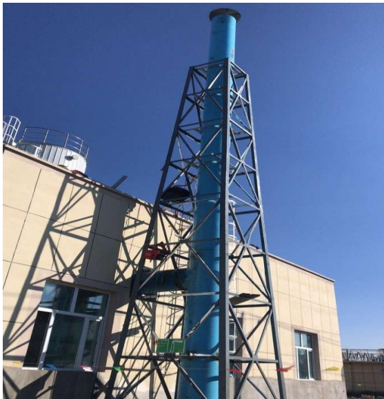
脱水机房废气 15m 排气筒排放
