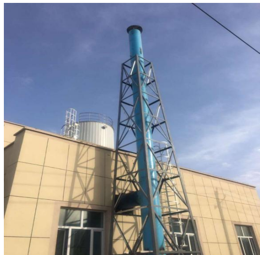
提升泵房及精细格栅间废气 15m 排气筒排放
