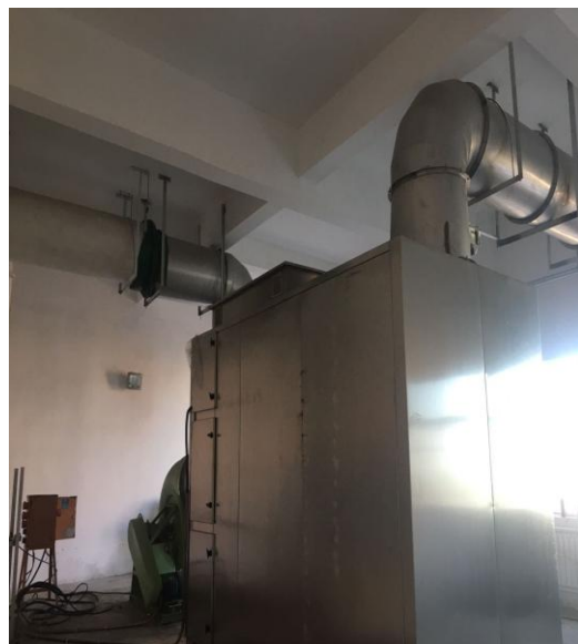
脱水机房离子除臭设备
